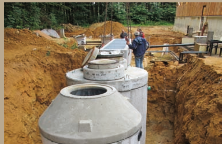
Das Regenwasser wird gesammelt, genutzt und vor Ort geklärt
