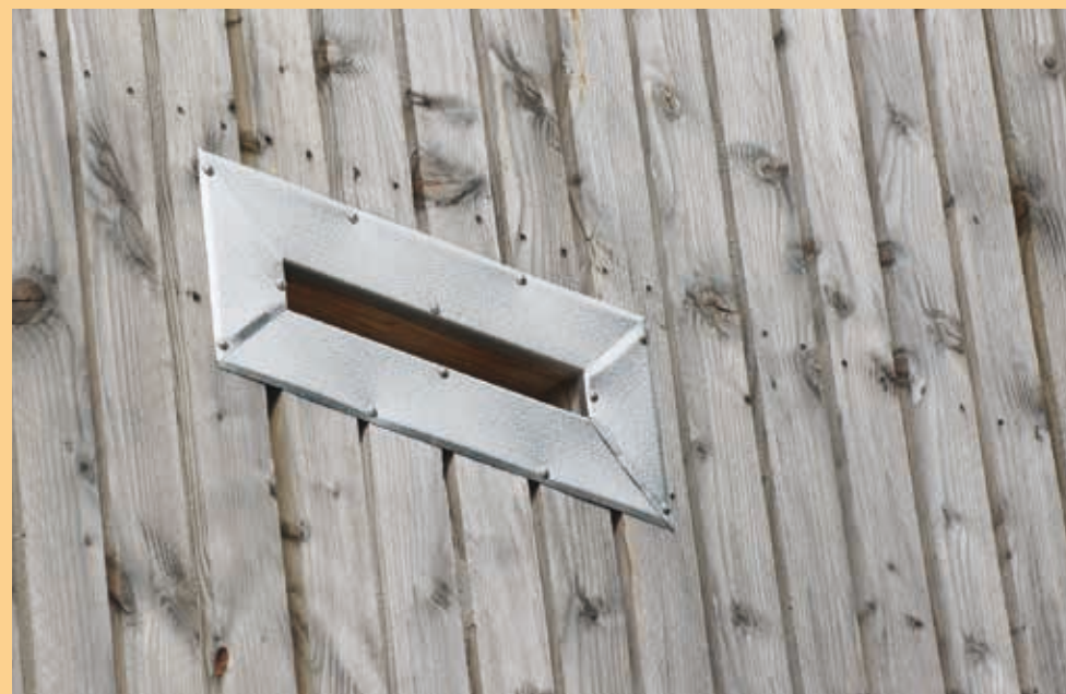
Artenschutzmaßnahmen dürfen bei einem Gebäude eines Naturschutzsyndikates nicht fehlen. So wurden zwei Fledermausquartiere (Foto) und 150 Brutmöglichkeiten für Mauersegler & Co in die neue Maschinenhalle integriert.
