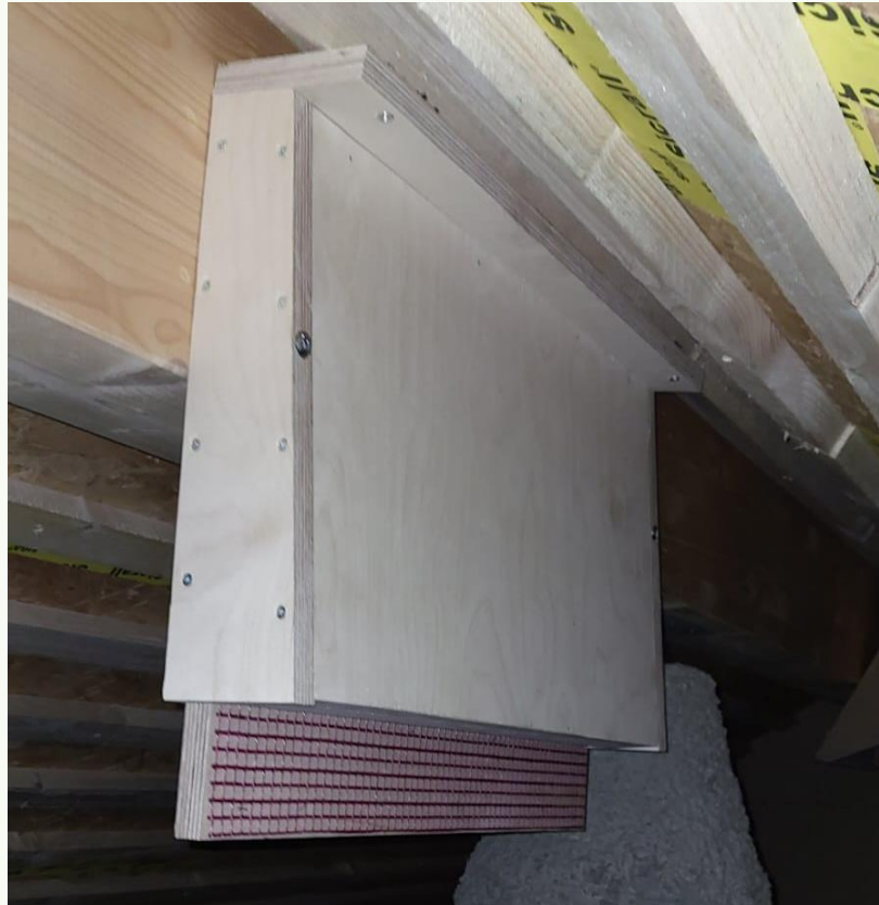
Planche pour chauve-souris à l'intérieur du toit
